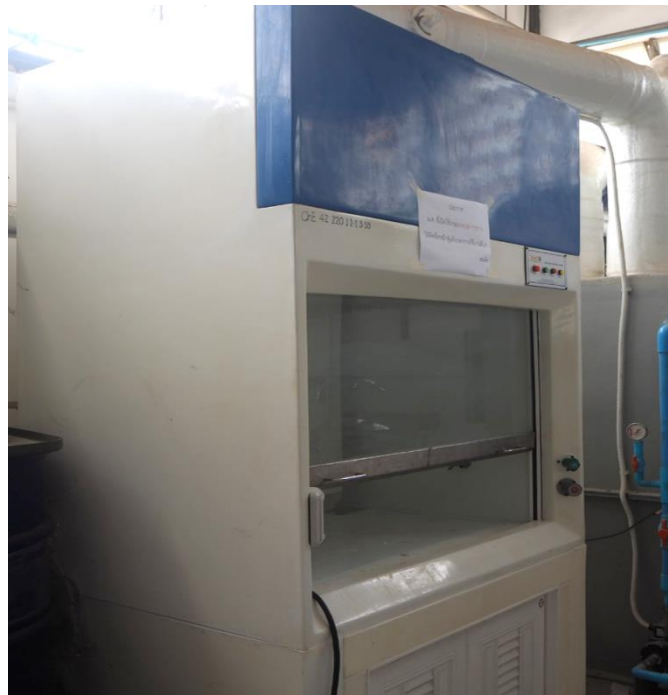
รูปที่ 4 ตู้ดูดควันภายในห้องปฏิบัติการภาควิชาวิศวกรรมเคมี
